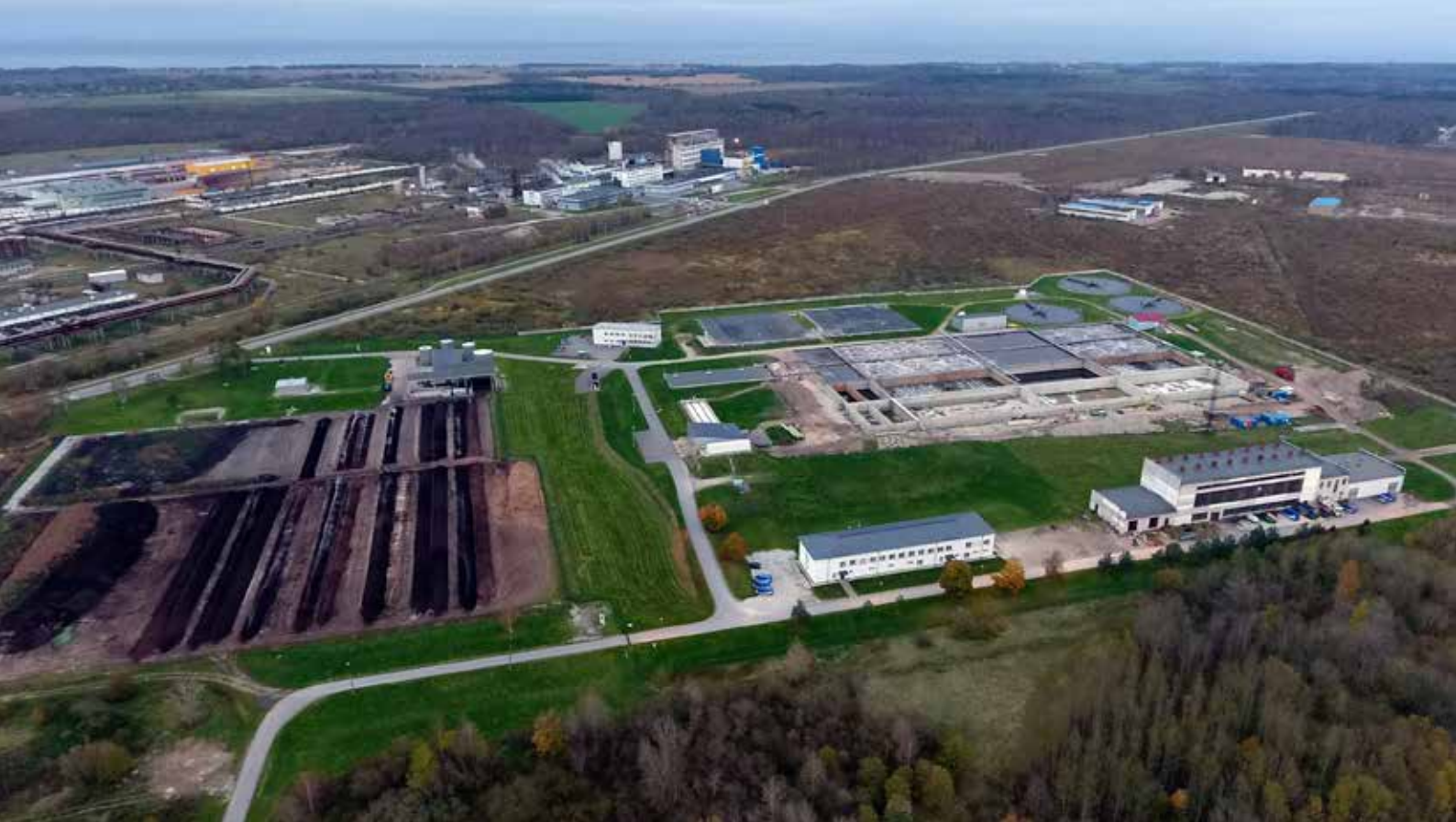
Kohtla-Järve puhastusseadmed – võimas kompleks, mis sisaldab basseine, torustikke, pumplaid ja suurel hulgal keerulist automaatikat. Foto: Järve Biopuhastus
